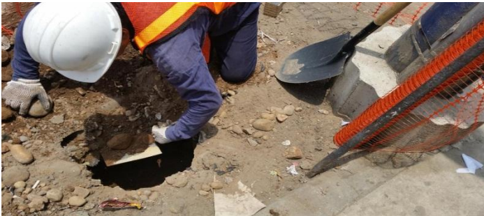
Fig. 1 - Muestra ubicación del pozo muy cerca de las masas a usar.
